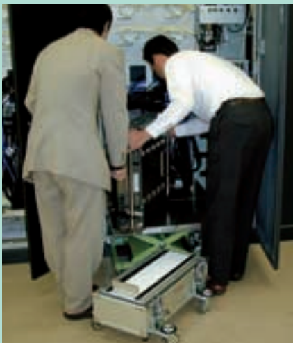
専用ケースで搬入されたPE(プロセッサエレメント)
